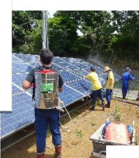
太陽光発電所メンテナンス
